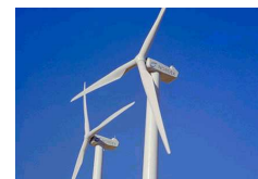
Aria ed energia pulita "Fattoria Eolica Pian dei Corsi"
